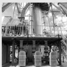
排煙脱硫装置
